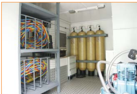
Рабочий отсек. Баллоны-воздухохранители. Стеллаж и оригинальные металлические сетки-корзины решают задачу компактного и удобного хранения бухт кабелей шланговой связки. Шкаф для просушки гидрокобнезонав.
